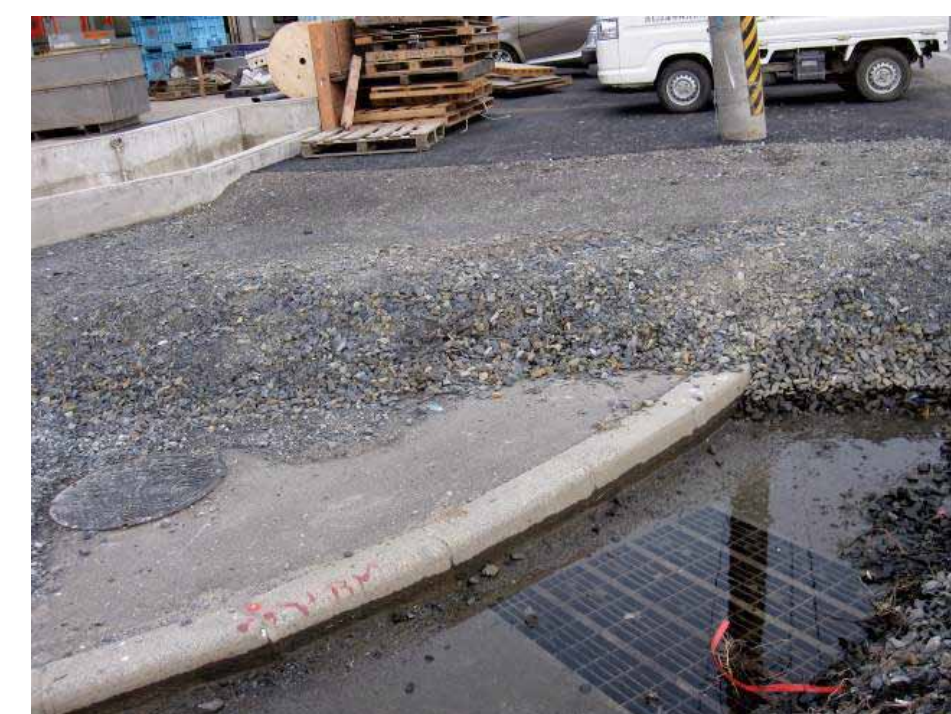
未だに地盤沈下している (建物部かさ上げ)
